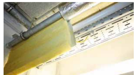
Auch im Bereich der Leitungsdämmungen treiben die dünnen Alubänder ihr Unwesen.
