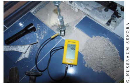
Der Estrich ist messbar nass, Wasser ist bei den Rissen eingedrungen.
