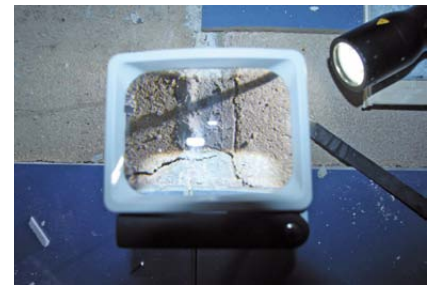
Der Estrich ist durch die Last nicht nur längs zur Wanne gebrochen.
