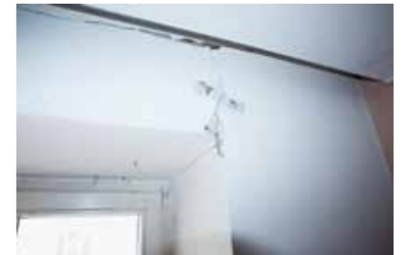
Konstruktionsfehler und Bauteilsetzungen – da reißt auch der einwandfreie Trockenbau.
