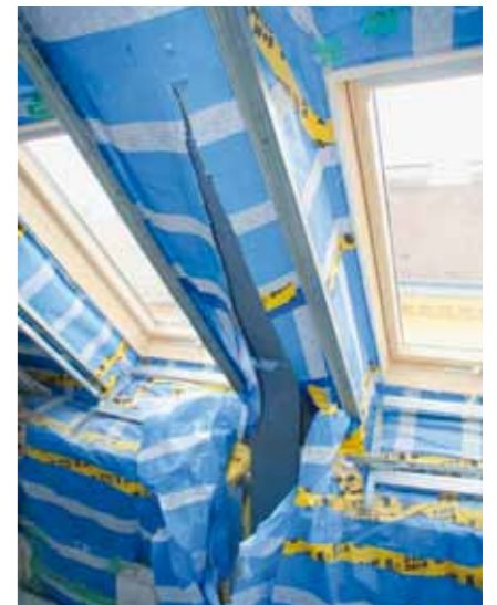
Totaler Trockenbauabbruch, Stahlträger ungedämmt, Unterkonstruktion fehlerhaft ...
