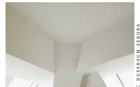
Hier treffen Stahlträger und Betonplatte auf den Holzdachstuhl, die gemeinsame Verkleidung ohne Bewegungsfugen hält das nicht aus.
