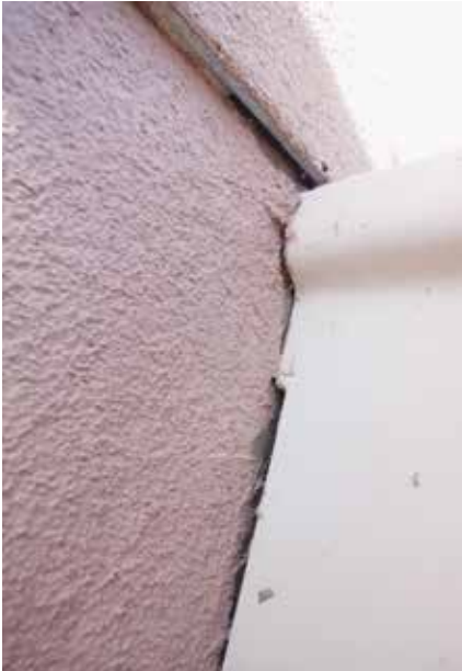
Fehlerhaft: Der Putz wurde erst nach der Lichtschachtmontage angebracht. Frostschäden sind die Folge.
