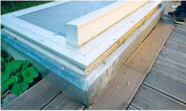
Salopp: Besonders kreative Lichtschacht-abdeckung wirkt nicht regenfrei und einbruchshemmend.
