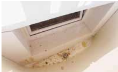
Schludrig: Die Perimeterdämmplatten sind nicht fachgerecht verlegt worden, die Fensterbank zum Kellerfenster fehlt.
