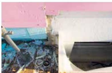
Halbfertig: Hier wurde zwar die Fassade vor der Lichtschachtmontage verputzt, dafür sind die Dämmplatten nicht richtig verlegt worden.
