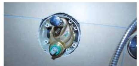
Mischerarmatur ohne Dichtmanschette. Eine dichte Anbindung zur Wand existiert nicht.
