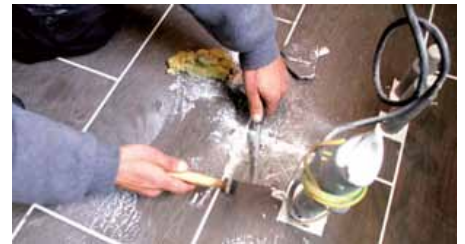
Fliesen nicht satt am Untergrund verklebt, eine Verbundabdichtung fehlt.
