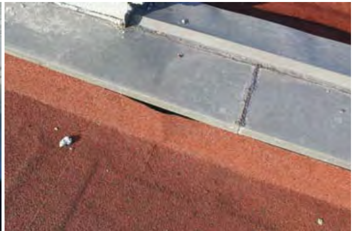
Auch Abdichtungshochzüge können fehlerhaft sein, Wasser läuft oben rein.
