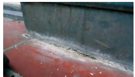
TIZi-Winkelbleche mit Fliesen und Estrich ohne vlies-bewehrtem Schutzanstrich = völlige Auflösung
