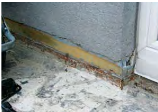
Terrasse nach 20 Jahren schadhaft, Winkelbleche verrostet.
