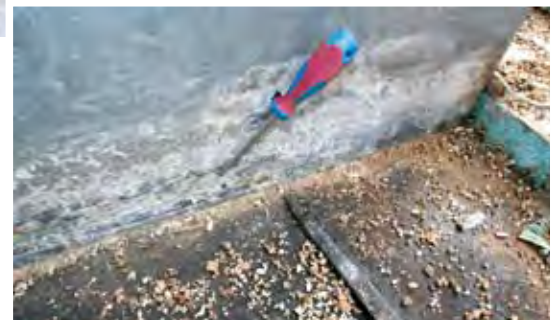
TIZi-Winkelbleche mit Platten in Kiesbett ohne Schutzanstrich = Lochfrass
