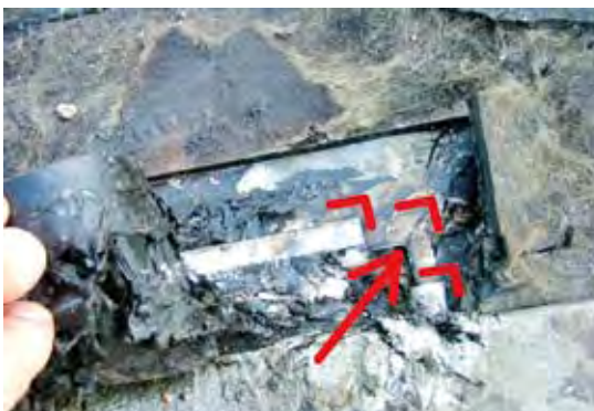
Eine Menge scharfer Kanten, keine Chance bei dünnen Abdichtungslagen.
