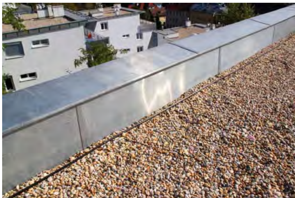
So wäre es richtig: Abdichtung hinter Schutzblech hochgefämmt. Ausführung durch die Firma Hirschner.
