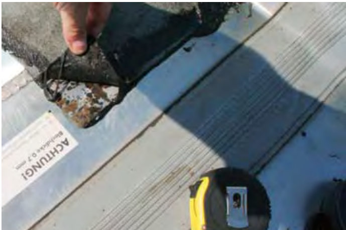
Untergrundvorbereitung mangelhaft, Abdichtung hält nicht.
