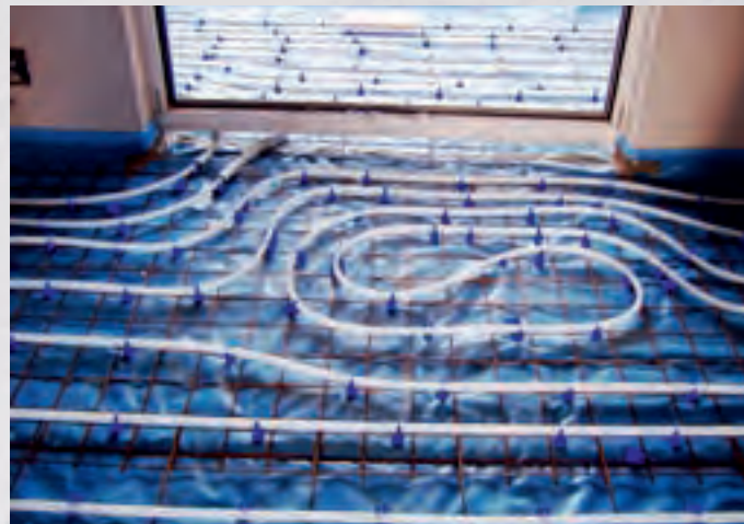
Annähernd dampfdichter Fußbodenaufbau, behindert die Austrocknung der Bodenplatte
