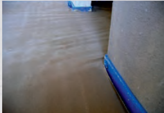
Nur über die inneren Ziegelmauern kann ein Feuchtetransport in den Raum stattfinden
