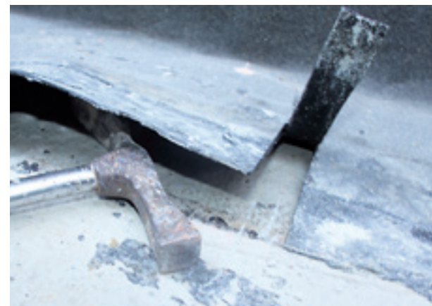
Das Abdichtungsende war nicht mittels Klemmleiste festgehalten, Wasser drang in den Keller ein.
