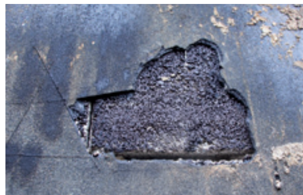
Vor 10 Jahren gebaut, 5 Jahre undicht, Betonschalsteinkeller mit einer Lage GV45 ist „Pfuscher am Bau“.
