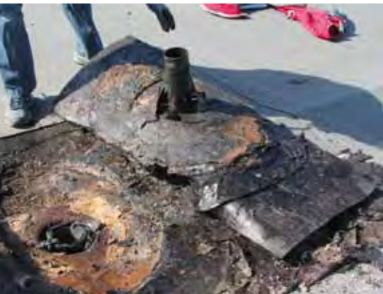
Der Gully ist zwar dicht bei Regenwasser, aber nicht luftdicht – Tauwasser sammelt sich unter der Abdichtung.
