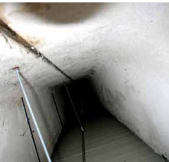
Eine Betonrippendecke mit Schimmelfall
