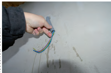
Tauwasser tropfen aus Elektroinstallationen, luftdichte Hohlwand Dosen fehlen.
