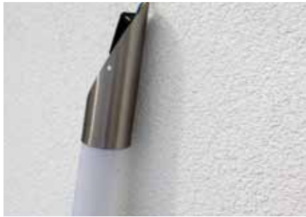
Nach Demontage der Wandlampe zeigt sich der Panerschlauch, der das Regenwasser in das Gebäude geführt hat.
