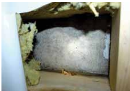
Holzstörender Pilzbefall an der Wandkonstruktion durch undichtes Blitzschutztürchen.
