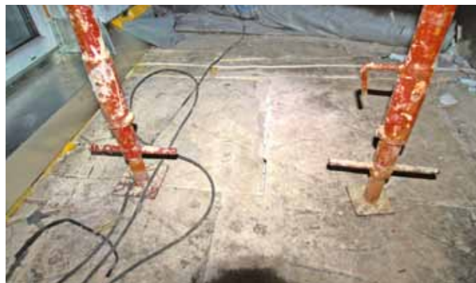
Die Druckfestigkeit von EPS-Dämmplatten ist gegenüber XPS-Platten schlechter. Beschädigungen während der Bauphase sind wahrscheinlicher.
