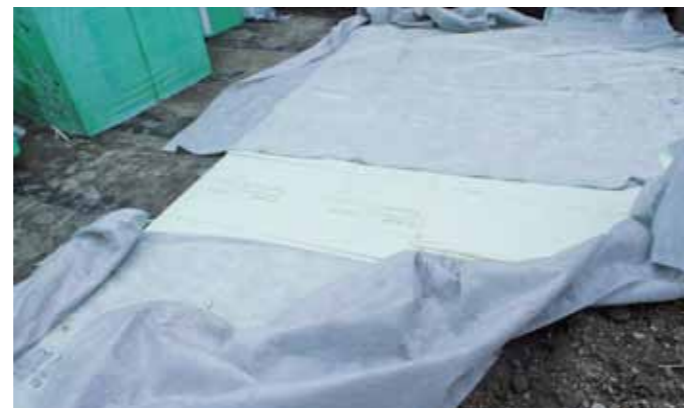
Auch extrudiertes Polystyrol funktioniert nur, wenn es fehlerfrei verlegt wird. Die Platten sind im Verband zu platzieren.
